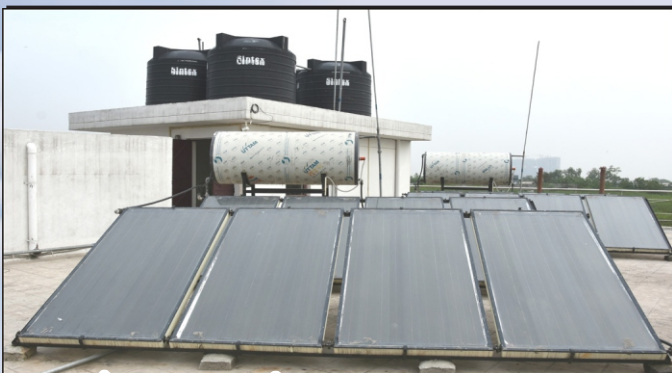
सौर तापन प्रणाली/ Solar Heating System
